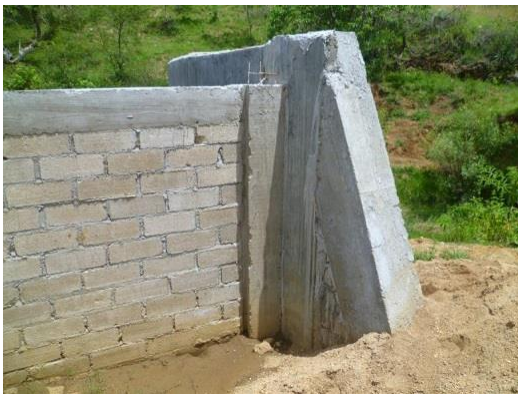
Figura 7. Refuerzo lateral por falta de empotramiento natural de la margen derecha.
