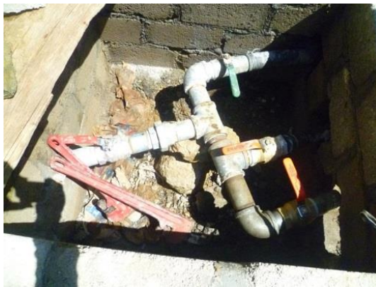
Figura 11. Válvulas para el control del riego, llenado a los estanques y emergencia.
